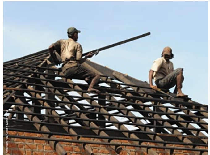
Intervention après le tsunami, Sri Lanka, juin 2010. Deux hommes travaillent sur un projet d'abri mis en place par les propriétaires et soutenu par les Sociétés de la Croix-Rouge suisse et américaine.
