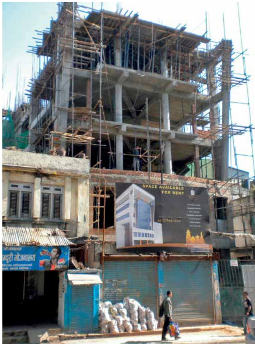
El rápido desarrollo urbano en Katmandú, Nepal, se está gestando en su mayoría sin permisos, a pesar de la existencia de códigos de construcción relevantes.
