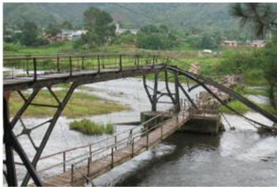
Photo 1: Le pont traversant la rivière Namorona à Ranomafana-Ifanadiana, détruit après la saison cyclonique 2007-2008.
